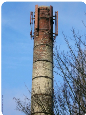
Cheminée de l'espace Cuppens à Loos transformée en support d'antennes-relais, photographie prise le 29/12/2007 © PROSCITEC.
