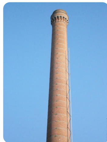
Cheminée la plus haute du Nord à Tourcoing (usine La Blanche Porte), photographie prise le 20/12/2007 © PROCISTEC.
